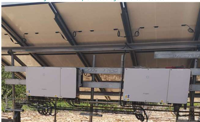
Figure 16 : Exemple d'onduleurs décentralisés
