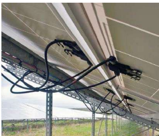
Figure 15 : Exemple de câblage sous les modules
