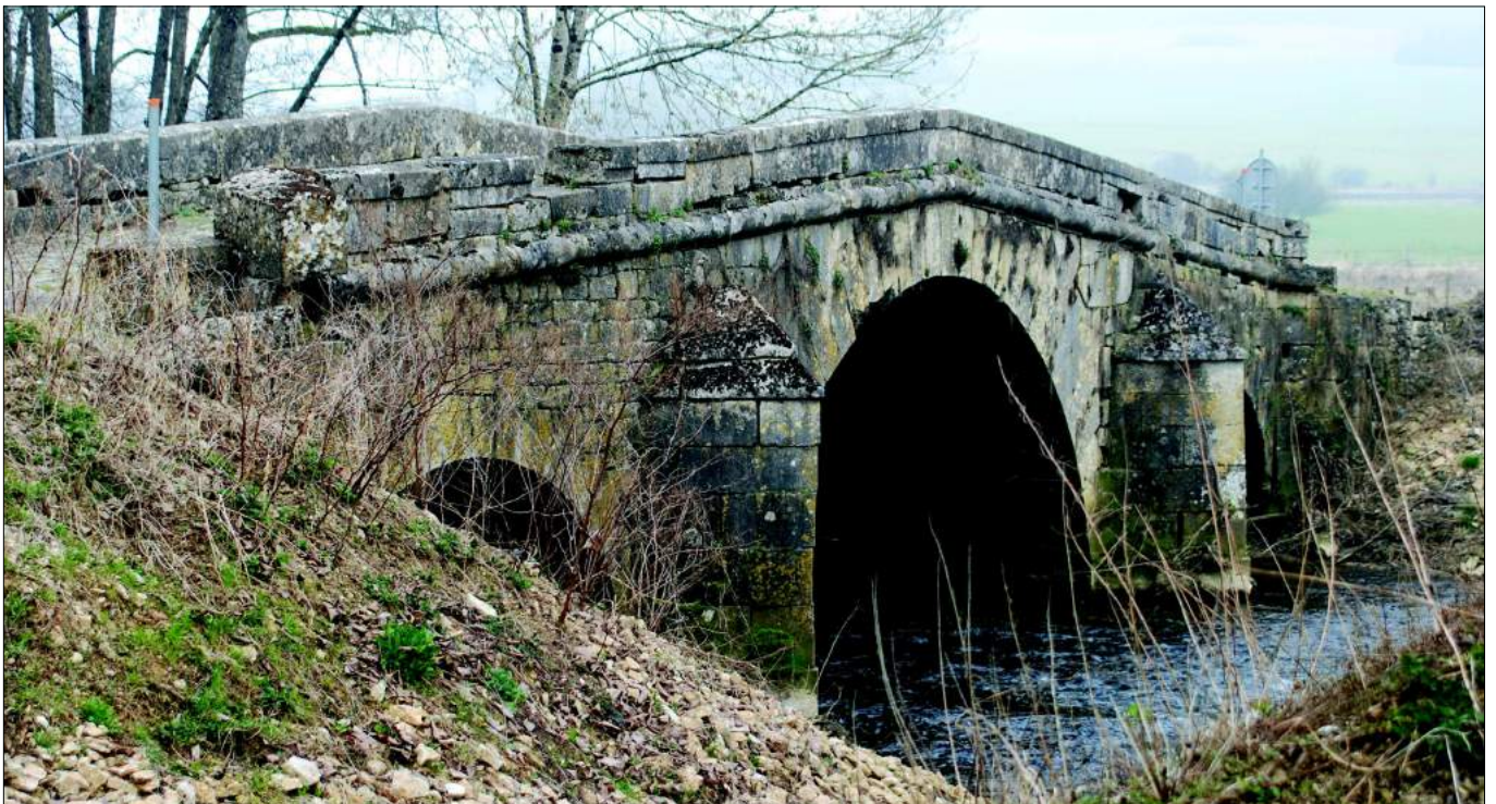
Une dépréciation du bel ouvrage du pont de Pré Gibert et franchissement de la Marne à Rolampont par des remblais.
