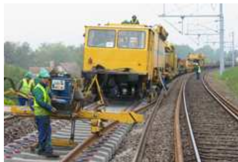
Figure 5 : Longs rails soudés sur traverses béton
