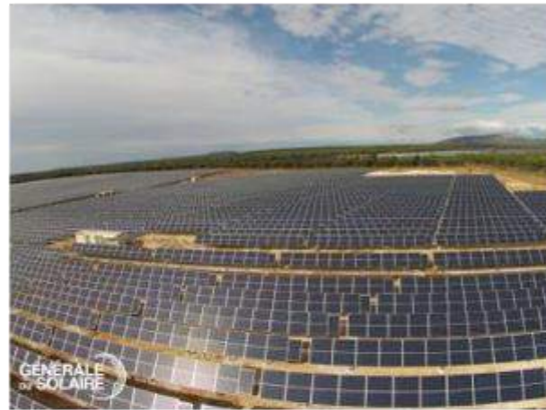
Centrale de Belvezet, Gard
