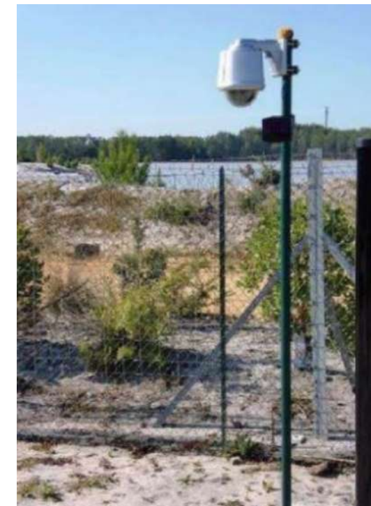
Photo 7 : Exemple de système de télésurveillance (© Opale)
