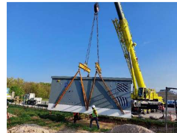
Photo 5 : Exemple de poste de livraison (© Opale)
