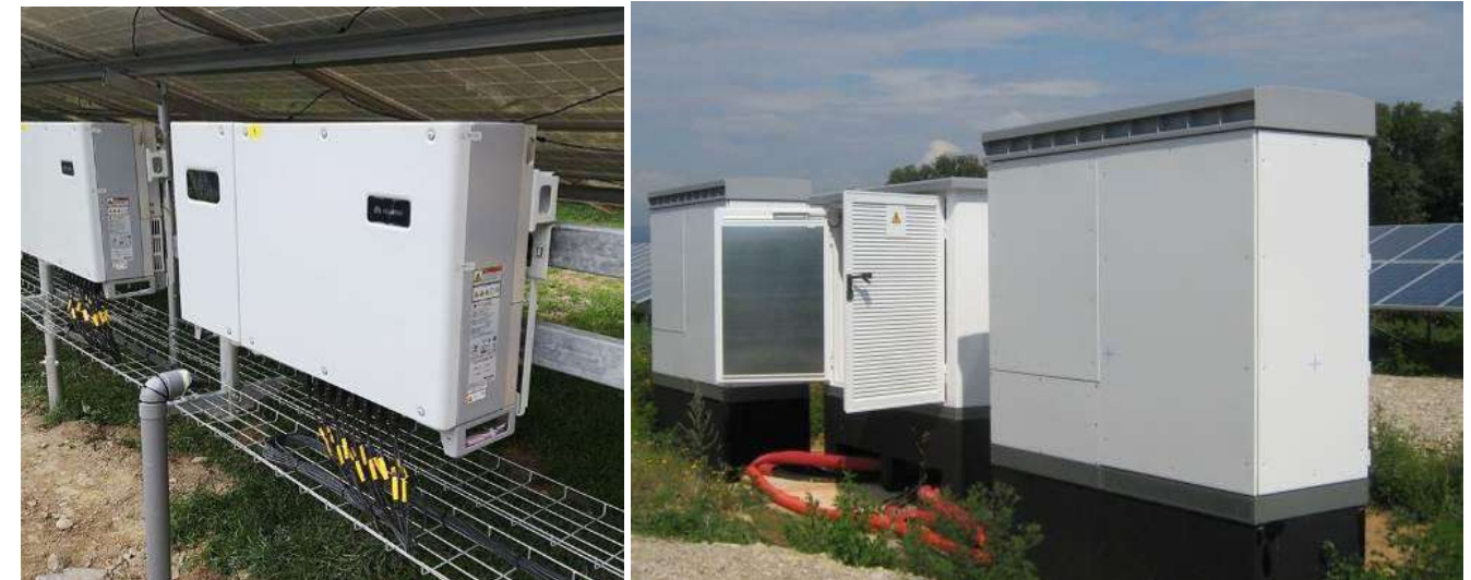
Photo 4 : Exemple d'onduleur et de transformateur(© Opale)
