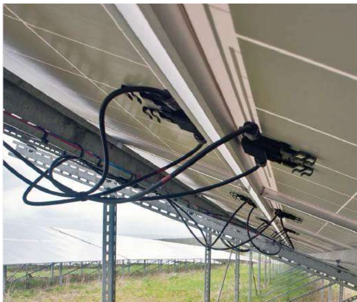
Photo 3 : Exemple de câblage sous les modules (© Opale)
