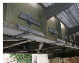
Absorbeur sur platelage
