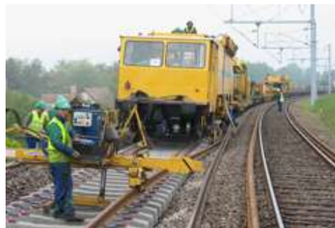
Longs Rails soudés sur traverses béton
